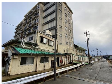
全体が傾き崩れたままの旅館
